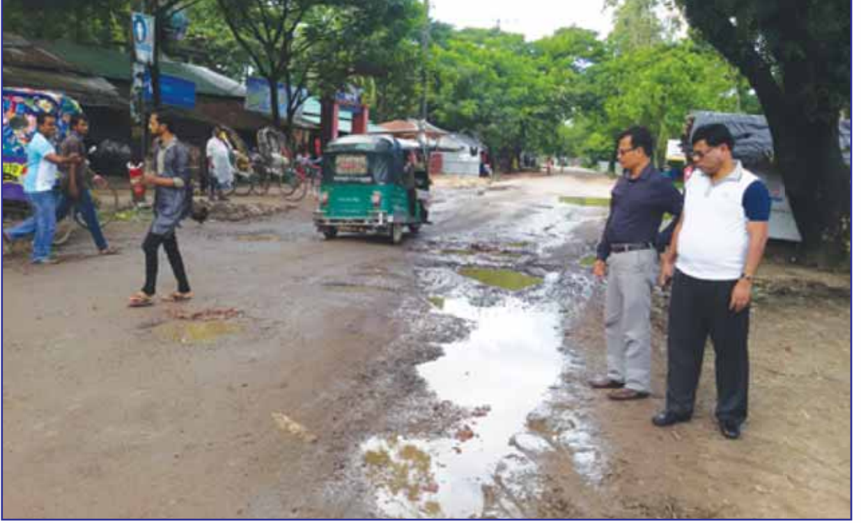
সড়ক পরিবহন ও মহাসড়ক বিভাগের মনিটরিং টিম-১০ কর্তৃক কক্সবাজার-টেকনাফ সড়কে গত বর্ষায় ক্ষতিগ্রস্ত অংশ পরিদর্শন
