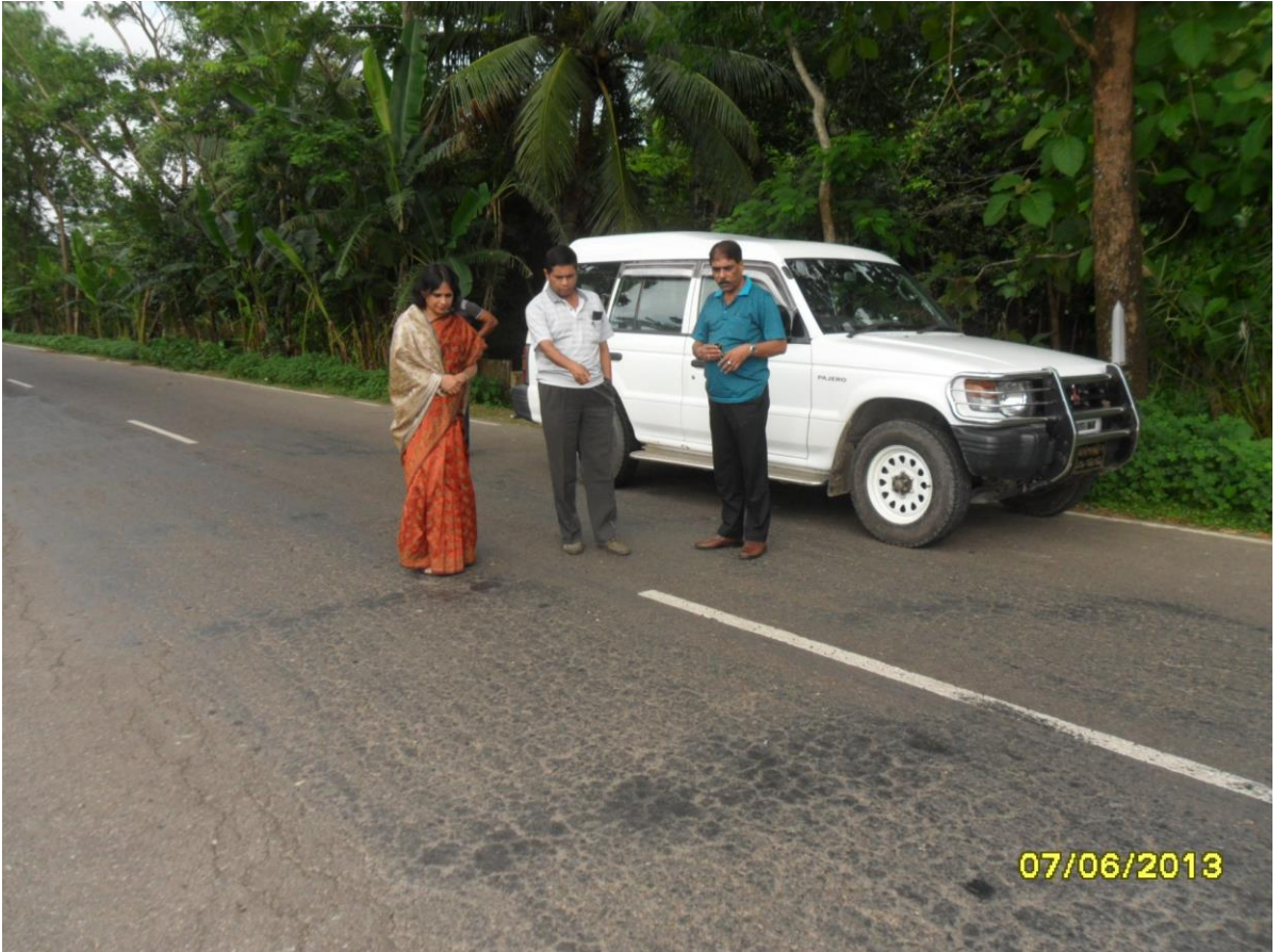
সড়ক বিভাগের মনিটরিং টিম-২০ কর্তৃক পটুয়াখালী সড়ক বিভাগের আওতাধীন পটুয়াখালী-আমতলী-বরগুনা-কাচিড়া আঞ্চলিক মহাসড়কের পটুয়াখালী অংশের পেভমেন্টের ফাটল পরিদর্শন।
