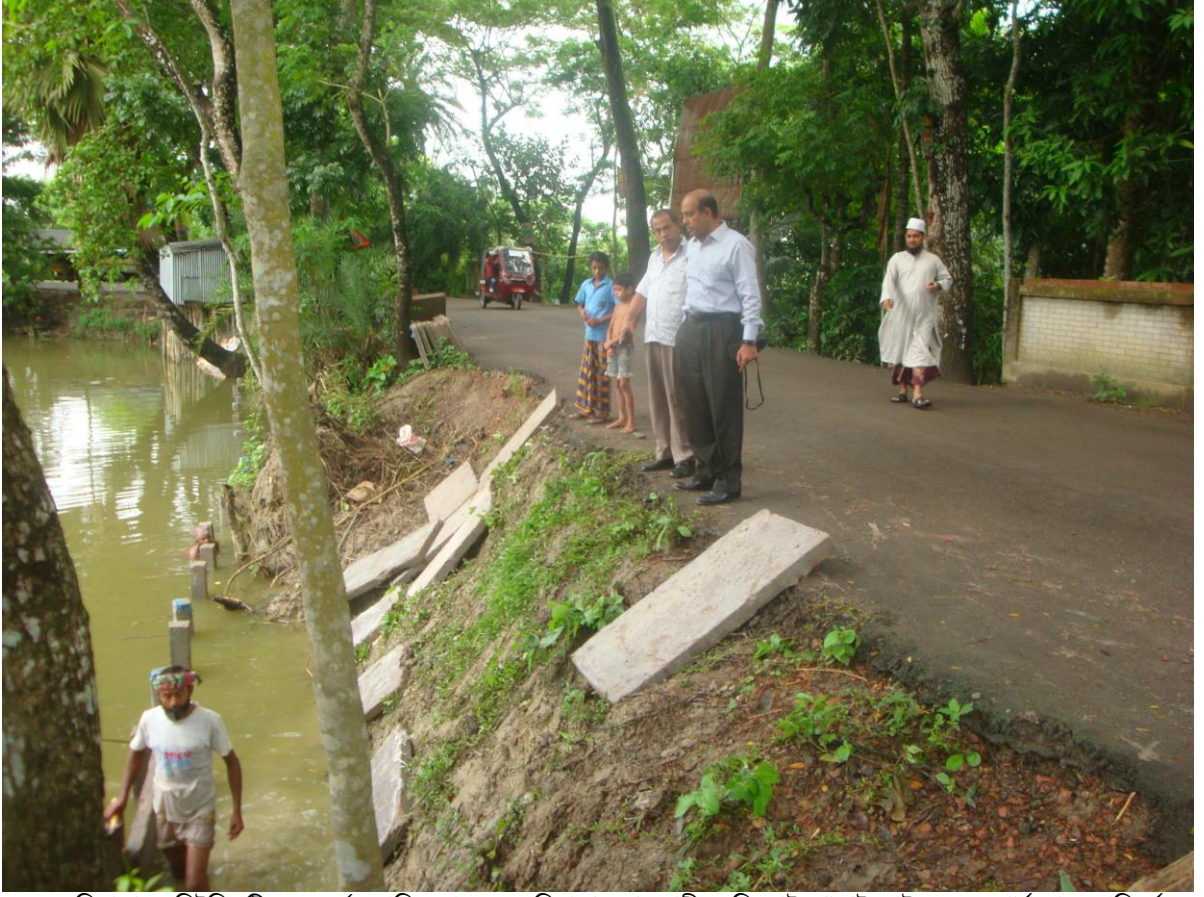
সড়ক বিভাগের মনিটরিং টিম-২১ কর্তৃক শরিয়তপুর সড়ক বিভাগের আওতাধীন বুড়িরহাট-গোসাইরহাট সড়কের পার্শ্ব ভাঙন পরিদর্শন
